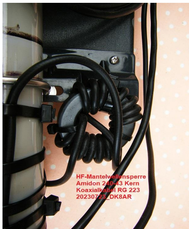
Bild 6 Die HF Mantelwellensperre
